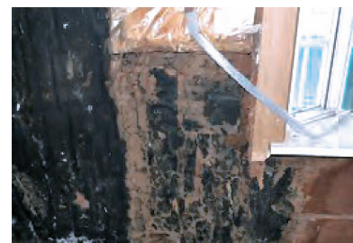
△ 因冷凝水結露而發霉的隔熱恆溫材料
